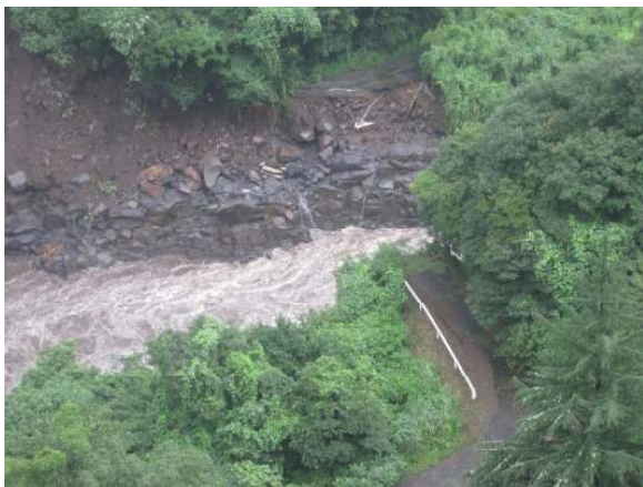
流失した黒川橋 2012年7月14日長陽大橋より撮影
