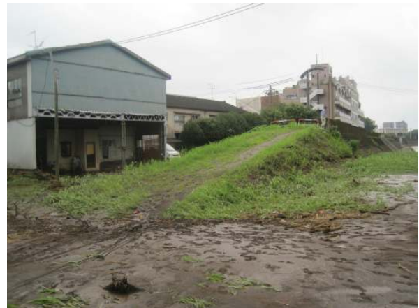
堤防が切れている竜神橋下流の左岸から浸水 2012年7月12日撮影
