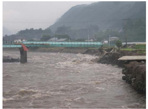
左岸側護岸が流失した代官橋 2012年7月14日撮影
