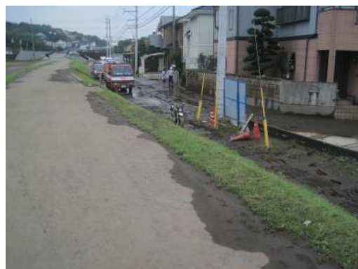
2012年7月12日撮影 小碓橋のすぐ下流(左岸)では堤防を越水
