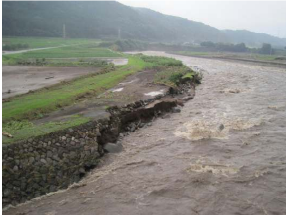
古いコンクリート製の護岸がこわれている 2012年7月14日撮影
