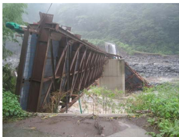
工事用仮橋も流失 2012年7月14日撮影
