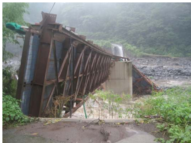
工事用仮橋も流失
