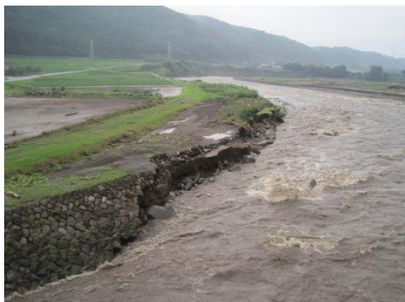
古いコンクリート製の護岸がこわれている
