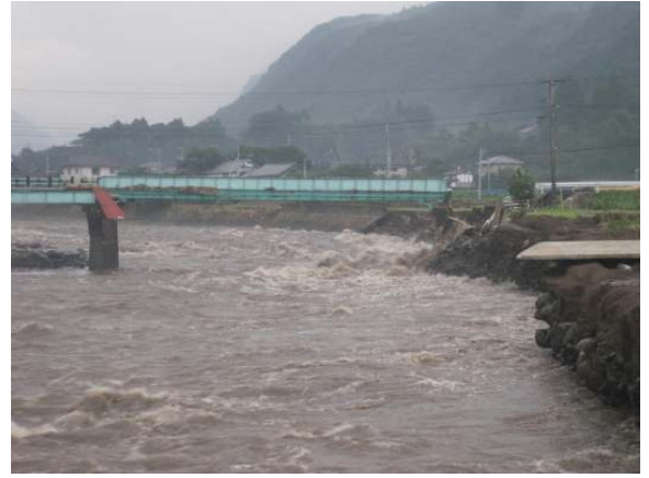
左岸側護岸が流失した代官橋
