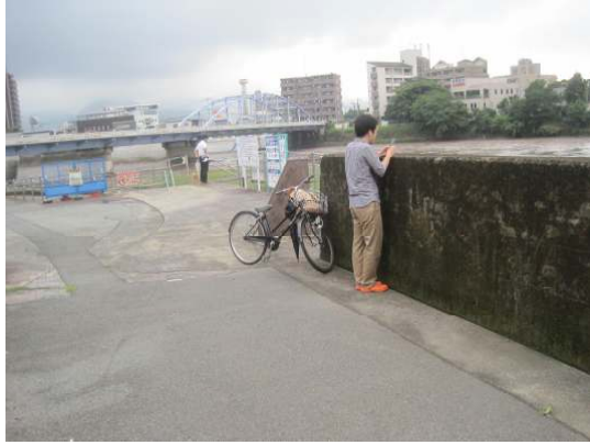
堤防が切れている子飼橋上流の左岸
