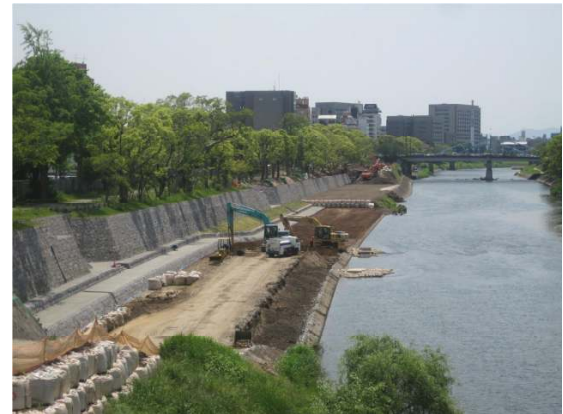
左岸側の改修工事も完成していない
