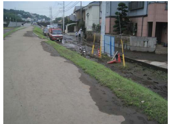
小碩橋のすぐ下流の左岸では堤防を越水
